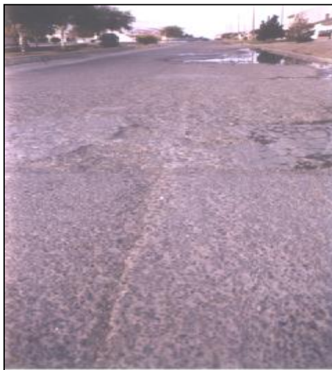
Estado del pavimento de hormigón previo al recapado.
